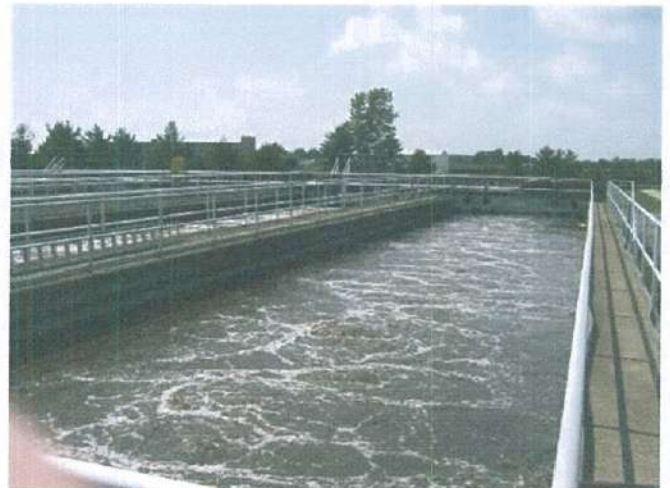
บ่อบำบัดน้ำเสีย
