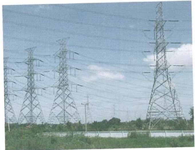
เสาไฟฟ้า
